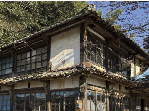
西面見上 (外壁や庇の一部に経年劣化が見られる)
