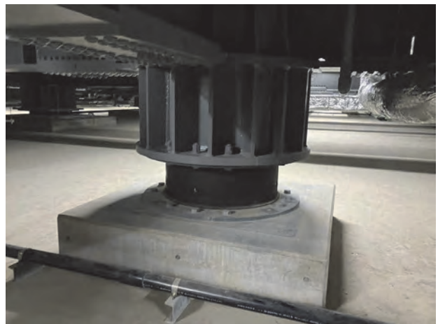
地下ピットの免震装置
