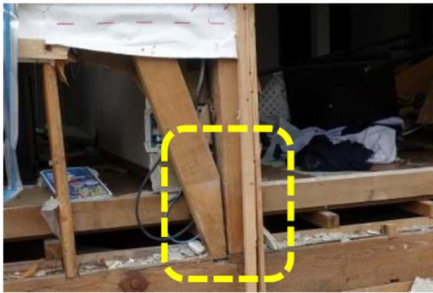
出典 熊本地震における建築物被害分析を行う委員会報告書(H28.9)
