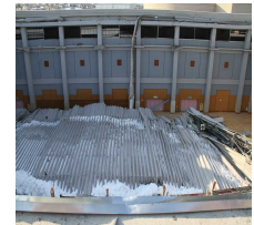
体育館の屋根崩落被害(埼玉県)
